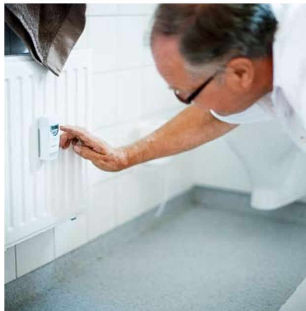
Alla manuella reglage på elementen har ersatts av automatiska termostater.
